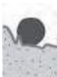
Големи части от армировката са много близо или точно до бетонната повърхност
